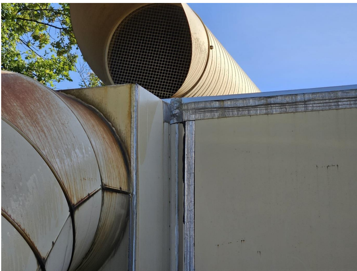
Photo 3 : La superstructure enveloppant les monoblocs n'est plus étanche
