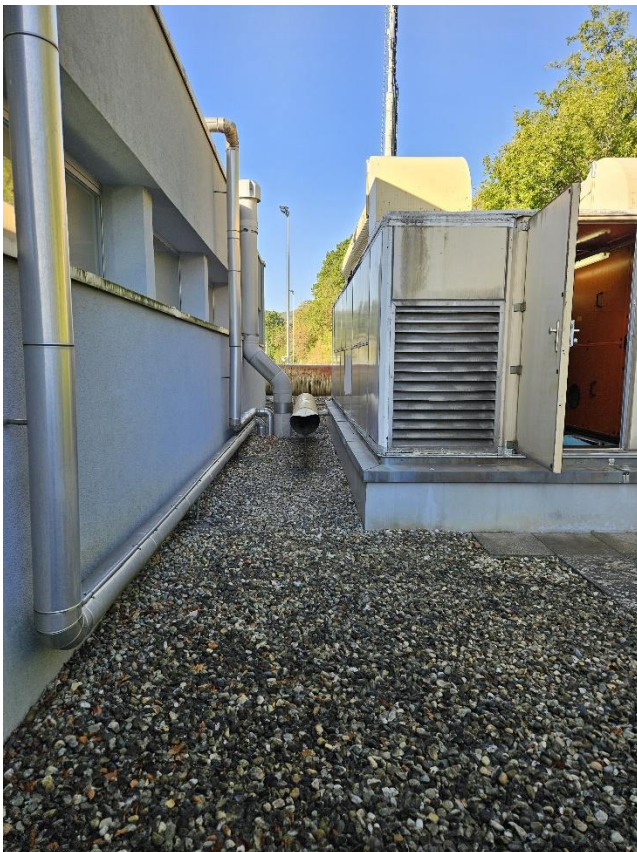
Photo 1 : Vue de la superstructure enveloppant les deux monoblocs de ventilation
